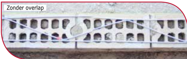
Overlap door boven elkaar geplaatste wapeningen: zonder dekking
